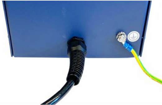
Abb. 2: Das Erdungskabel (hier gelb-grün) muss am Schutzleiteranschluss der Interface Box angebracht werden!
